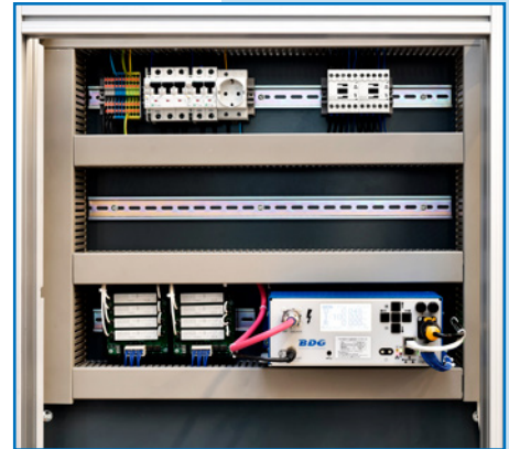
Einbausituation im Schaltschrank
