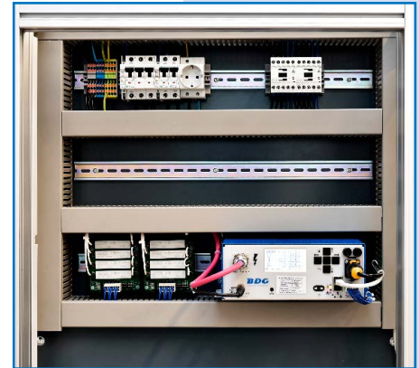
Einbausituation im Schaltschrank
